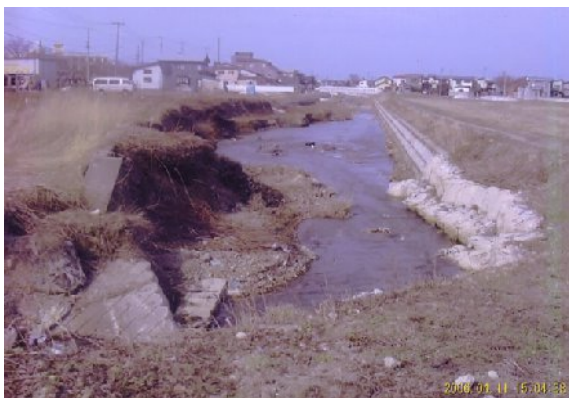
[写真4] 改修工事中断箇所
