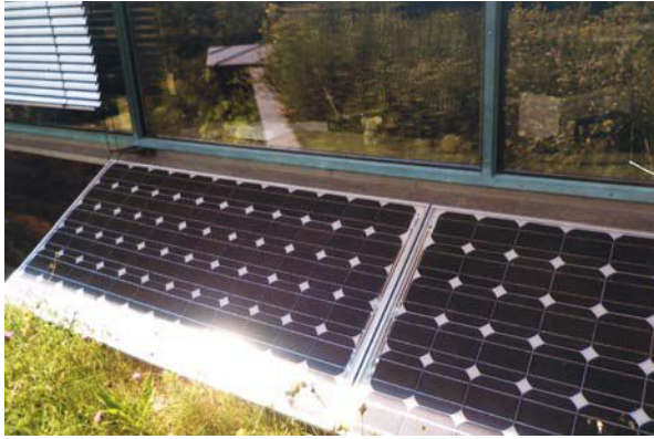
写真49 2階の太陽光発電
